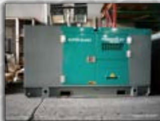
45kva 230v 3ph - Cavite
