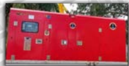
160kva 3ph 440v - Pampanga
